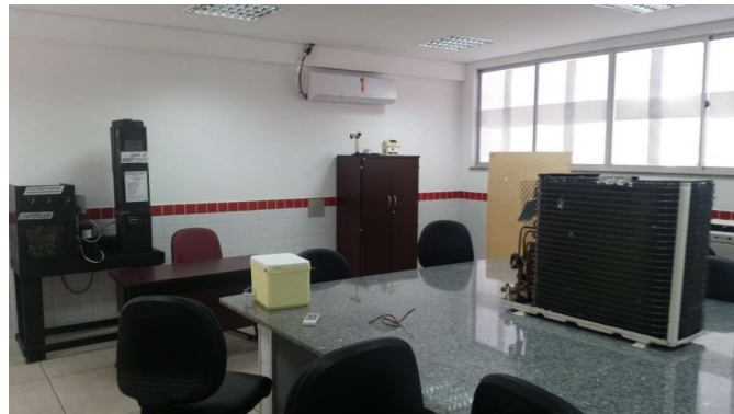
Figura 2 - Laboratório de Refrigeração e Climatização.
