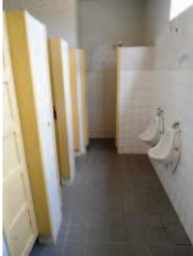
Sanitário masculino (estado de conservação semelhante aos demais)
